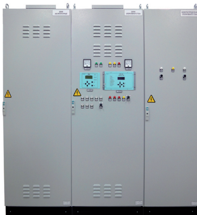
Щит оперативного тока из 3 шкафов (слева направо): шкаф аккумуляторный ШНЭ8004; шкаф оперативного тока ШНЭ8003 с зарядно-питающими устройствами ЗПУ-10П и системой контроля изоляции ЭКРА-СКИ; шкаф распределительный оперативного тока ШНЭ8001.
